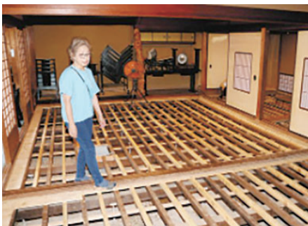
浸水被害を受けた床の乾燥風景
